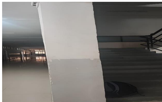
FIG.NO.7 UN DAMAGED COLUMN.
