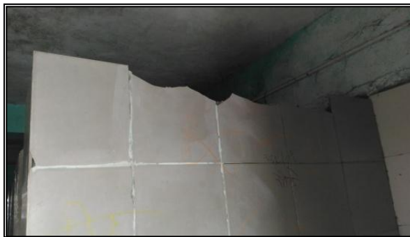
Fig.5 Broken toilet dado
